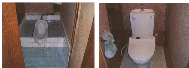
BEFORE く和式便器の洋式化く AFTER 立ち座りの困難を解消します。立ち上がり動作が不安定な方は介護する方も不安が軽減します。シャワートイレは保険外
